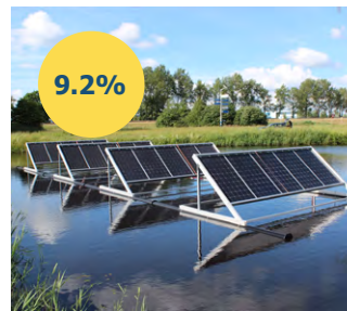
Zonnepanelen op water
